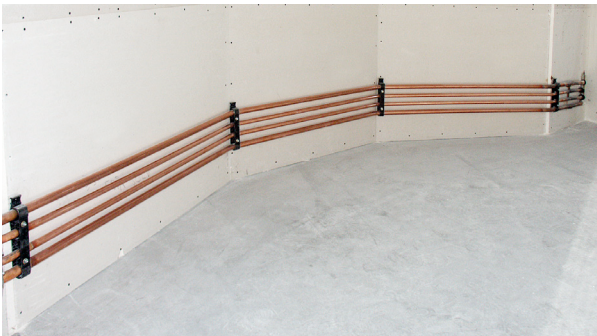
Hårda kopparrör, Cupori 110 Premium, monterade utmed vägg
