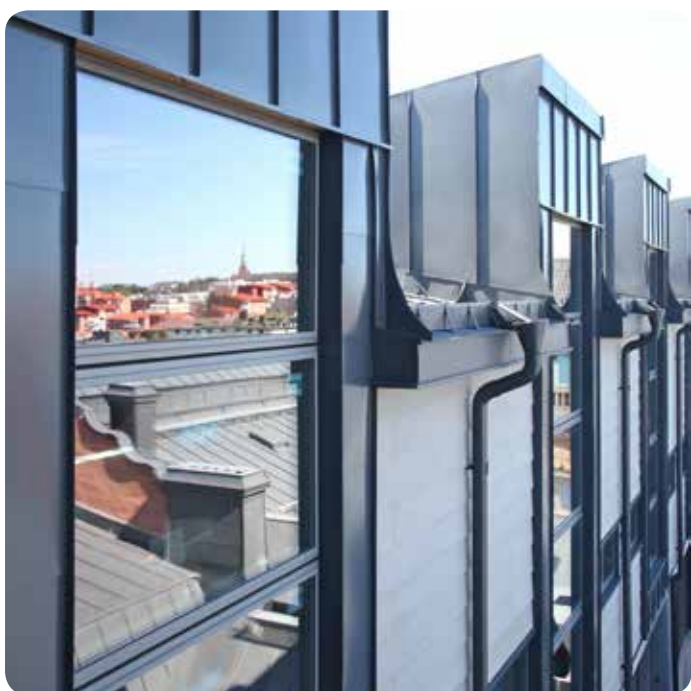
Till vänster: The Lamp Hotel i Norrköping med bandtäckning och takavvattnings Tradition i kulör PL20 mörkgrå.
