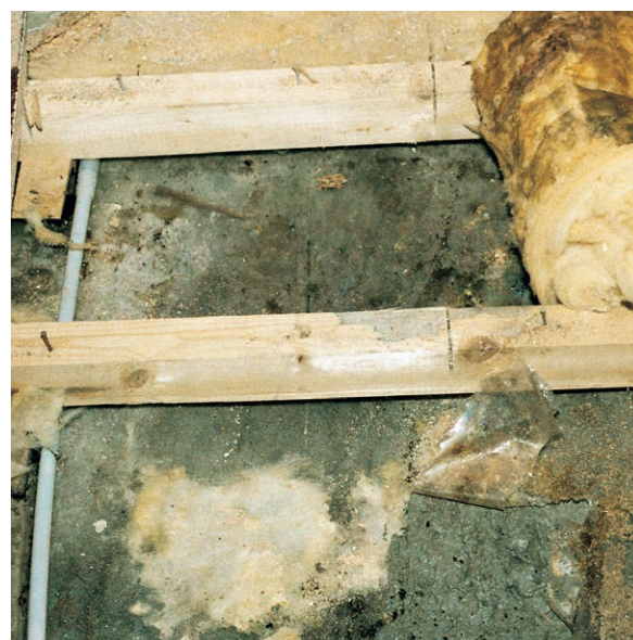
Fukt har trängt igenom den underliggande folien och har medfört att spånskivan svällt, nedbrytning av lim och blåsbildning på mattan.
