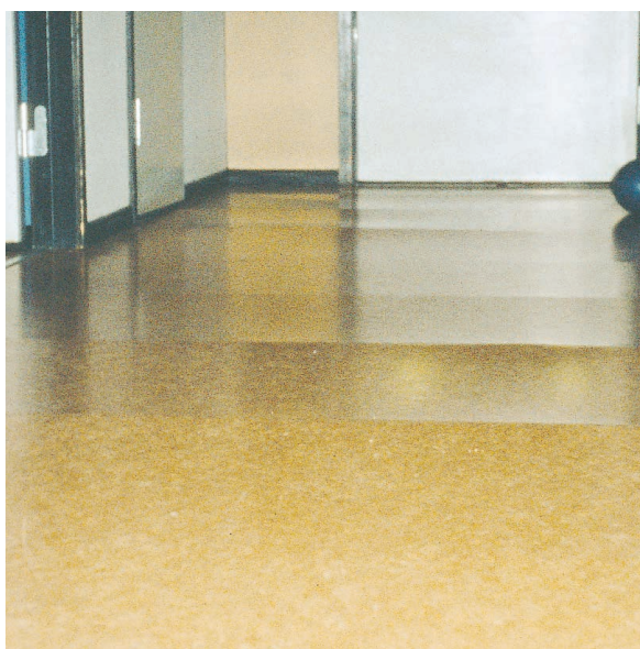
Fukt från mark har trängt igenom betongen/ plastfolien och orsakat mögeltillväxt.
